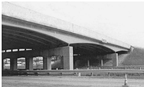
Figura 8. Puente de carretera postesado con AMF, Michigan, Estados Unidos.
