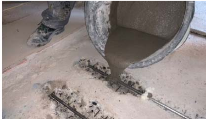
Figura 12. Modificación de un edificio residencial de varios pisos en Münchenstein, Suiza, utilizando barras de AMF subsuperficiales en la losa 44 .
