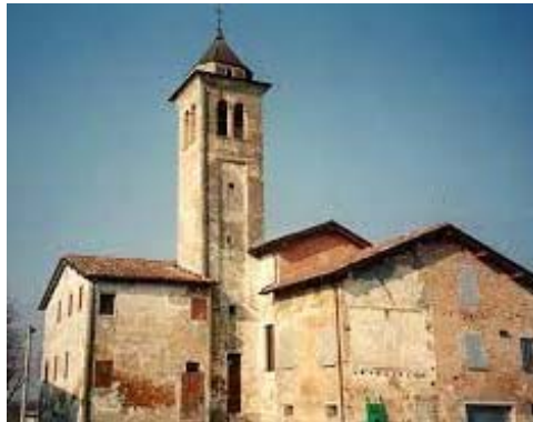
Figura 9. Iglesia San Giorgio en Trignano, Italia, reforzada con dispositivos antisísmicos basados en AMF.
