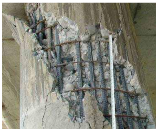
Figura 13. Falla por corte en una columna – Wenchuan, China 2008 (foto: FHWA) (31)
