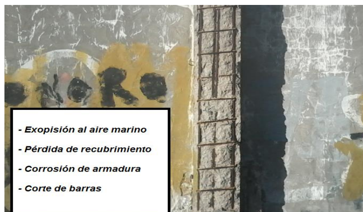
Figura 4: Corrosión de armadura por exposición al ambiente marino.
