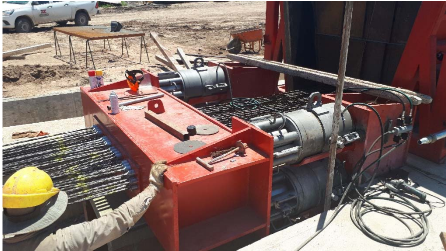
Figura 5. Vista del cabezal móvil del banco de pretensado de 1200 t de capacidad
