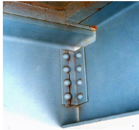
Figura 21: Fisuras en uniones roblonadas.
