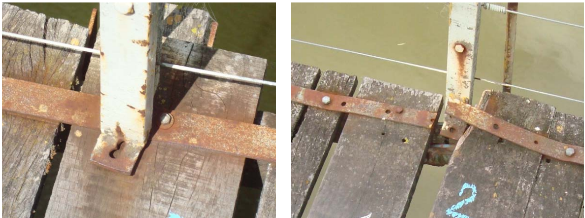
Figura 17: Pérdida del medio de unión al tablero de arcos y flejes
