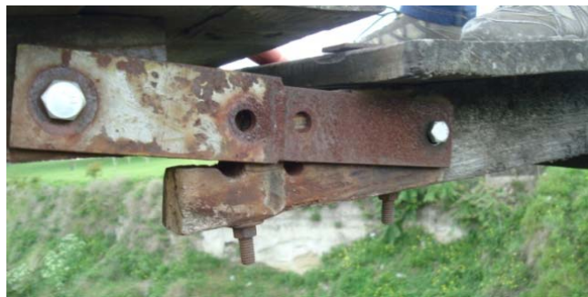
Figura 4: Roturas en zona de articulación
