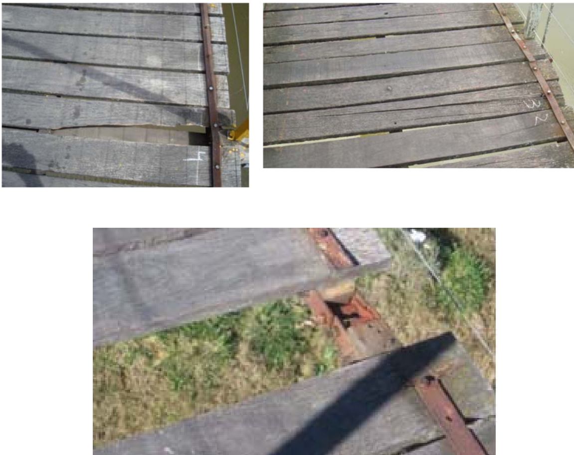
Figura 3. Daños y falta de tablas
