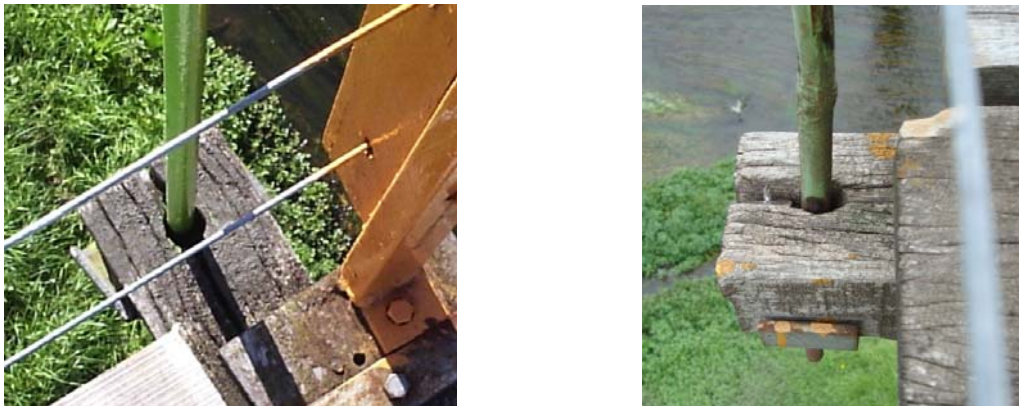
Figura 7: Deterioros en la unión de la péndola con la vigueta
