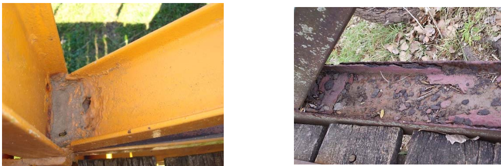
Figura 8: Zona de encuentro de dos perfiles y corrosión en perfil a nivel del tablero
