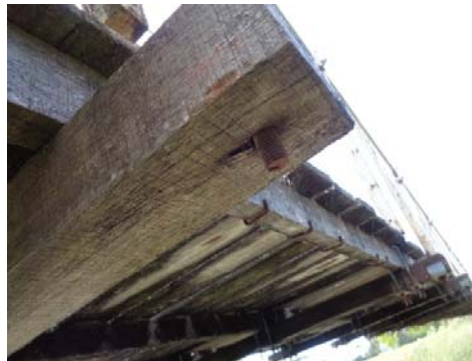
Figura 14: Pérdida de medio de unión a la vigueta
