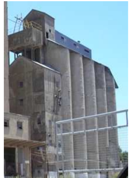
Figura 2. Silos y Estacion Elevadora
