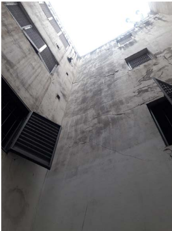
Figura N°1: se observan fisuras diagonales en el muro interior.
