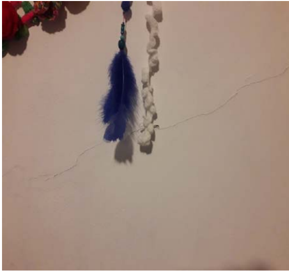
Figura N°4: Fisuras en el interior del edificio.
