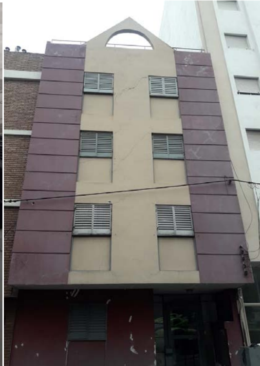
Figura N°2: se observan fisuras diagonales en la fachada.
