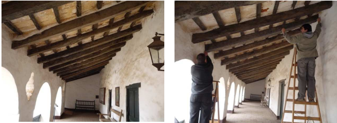
Fig. 8. Galería Oeste en Planta Alta - Estructura de Cubierta sobre Galería Oeste en planta alta (lateral de iglesia)
