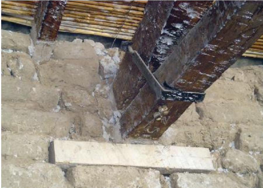
Figura 4. Vista del apoyo de la viga reticulada de madera sobre el muro de adobe.
