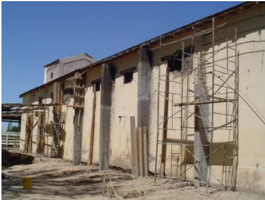
Figura 12. Vista del muro Este durante la construcción de las columnas de refuerzo.
