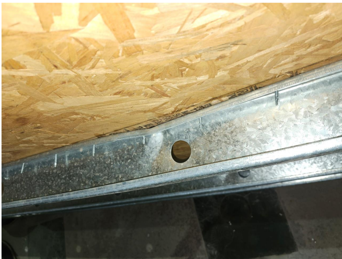
Figura 8. Abolladura de perfiles en zona central
