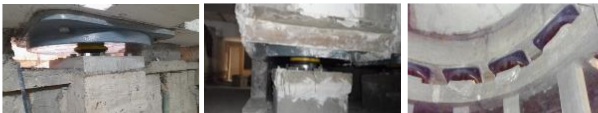
Figura 23 – Distintos aisladores instalados. La central es en caja de ascensores.
