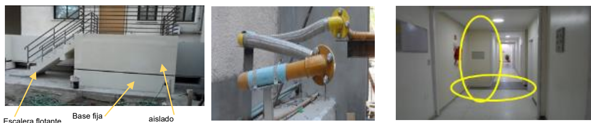
Figura 28 – Juntas sísmicas: salida de emergencia, junta flexible Gas, pasillo interno.
