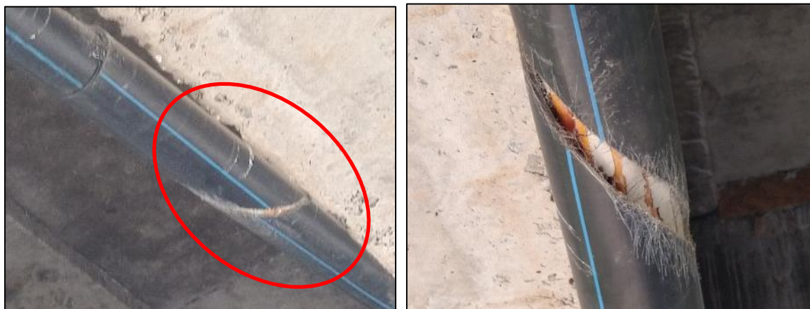
Figura 54 y 56. Vaina rota en tensor de viga V3
