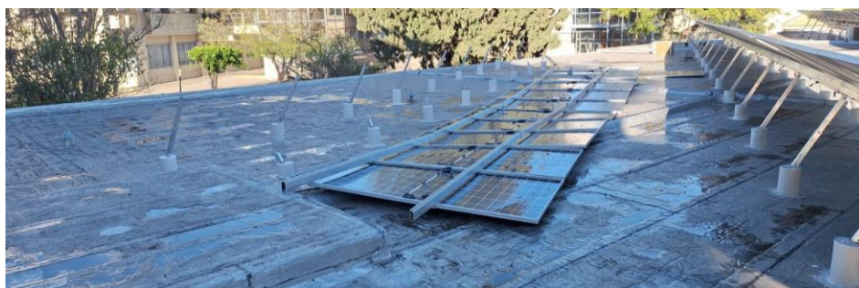
Figura 3: Falla de mesa fotovoltaica
