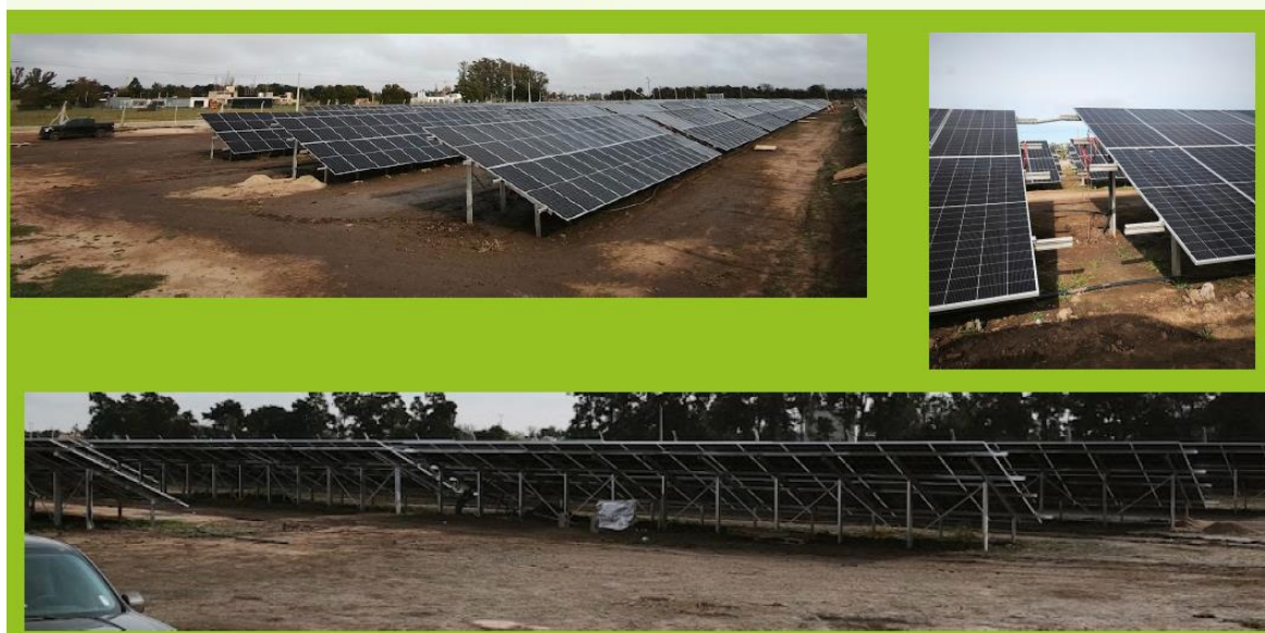
Figura 5: Parque solar realizado en la localidad
