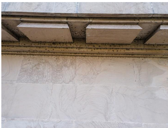
Figura 8. Colonia biológica identificada en el edificio FIUBA, sede Paseo Colón 850
