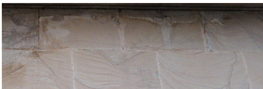
Figura 9. Eflorescencias identificadas en el edificio FIUBA, sede Paseo Colón 850
