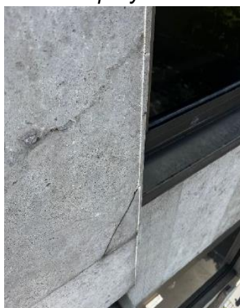
Figura 5. Fisura en el proyecto ubicado en región parisina
