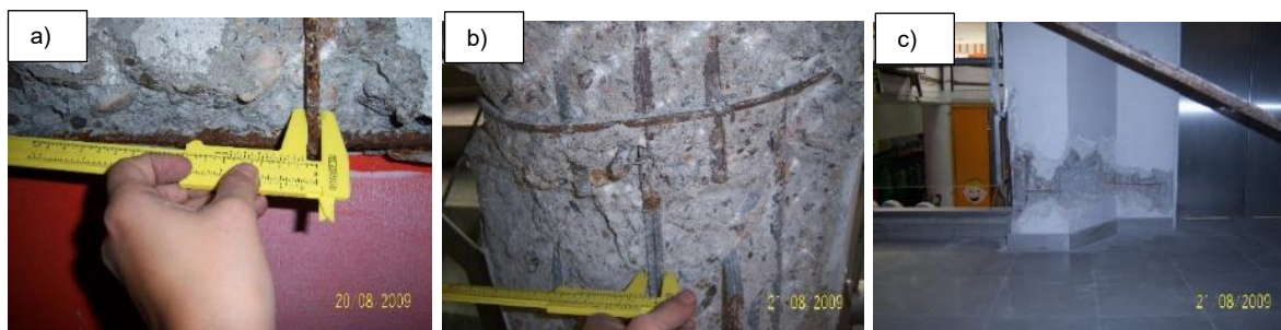
Figura 6. a) Acero corroído. b) Deficiencia longitud de empalme. c) Falta de recubrimiento.
