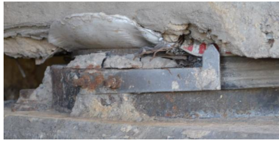
Figura 10. Detalle del apoyo – Gran desplazamiento lateral de la lámina de PTFE en estribo Oeste, Aguas abajo, en el Puente Zanja la Zorra
