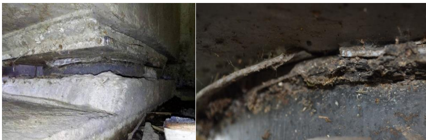
Figura 8. Detalle del apoyo – Leve desplazamiento de la lámina de PTFE en estribo Este, Aguas arriba, en el Puente Paranacito Victoria – Desplazamiento lateral y longitudinal
