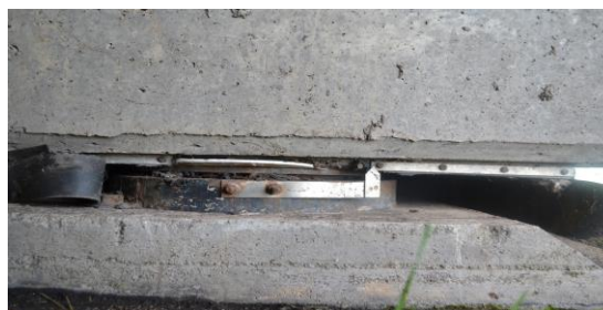
Figura 9. Apoyo 1, Estribo oeste, aguas abajo, del puente Paranacito Rosario. Campaña 2018. Leve desplazamiento lateral de la lámina de PTFE. (Identificado en 2018)
