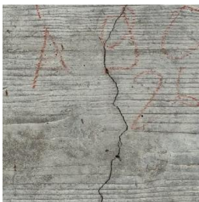
Imagen original de una fisura (S2DS)
