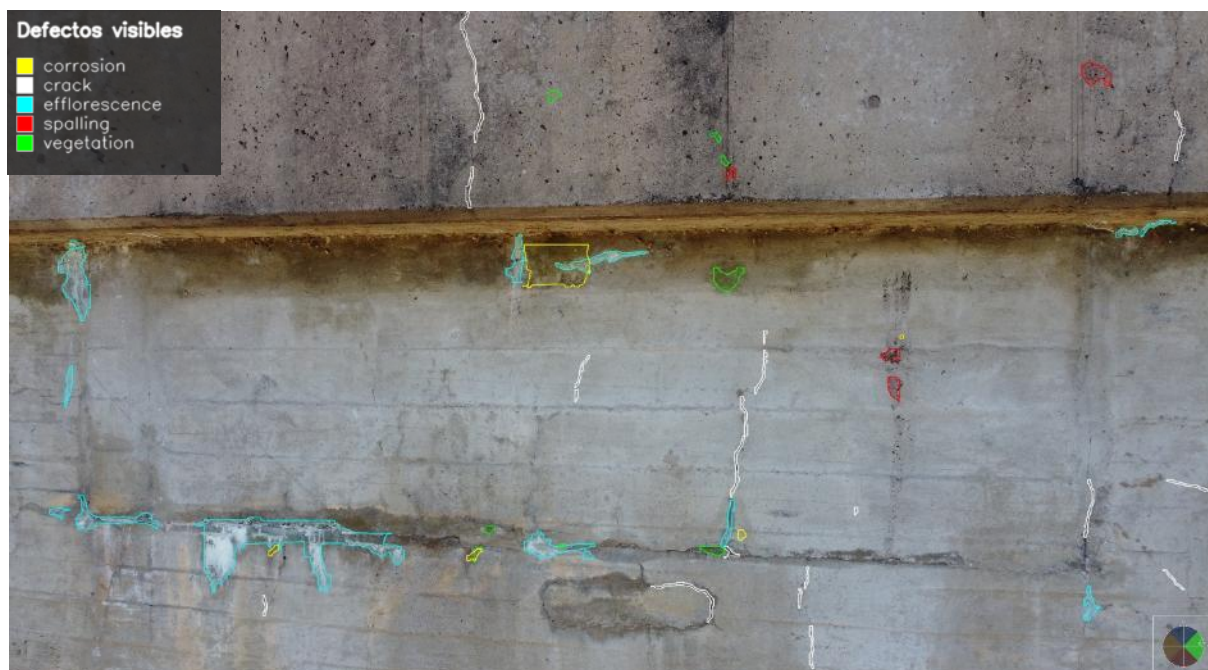
Figura 11. Sector Este con presencia de fisuras verticales y eflorescencias en zonas de filtración del agua y en zonas de fisuración. Puede observarse moho en la unión de la cenefa superior con el paramento inferior producto de la concentración prolongada de humedad en dicha zona.
