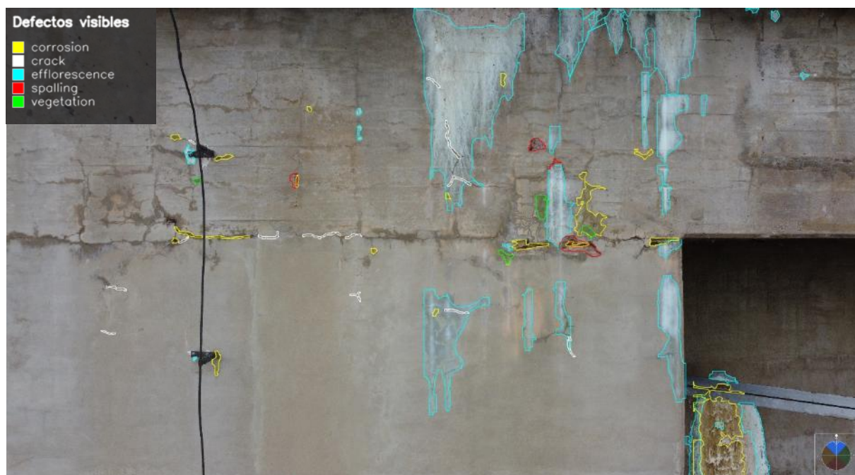
Figura 10. Sector norte con presencia de eflorescencias en coincidencia con zonas de escurrimiento del agua y junta constructiva. Presencia de corrosión de armaduras y pequeño desprendimiento del H° en concurrencia con la armadura longitudinal.
