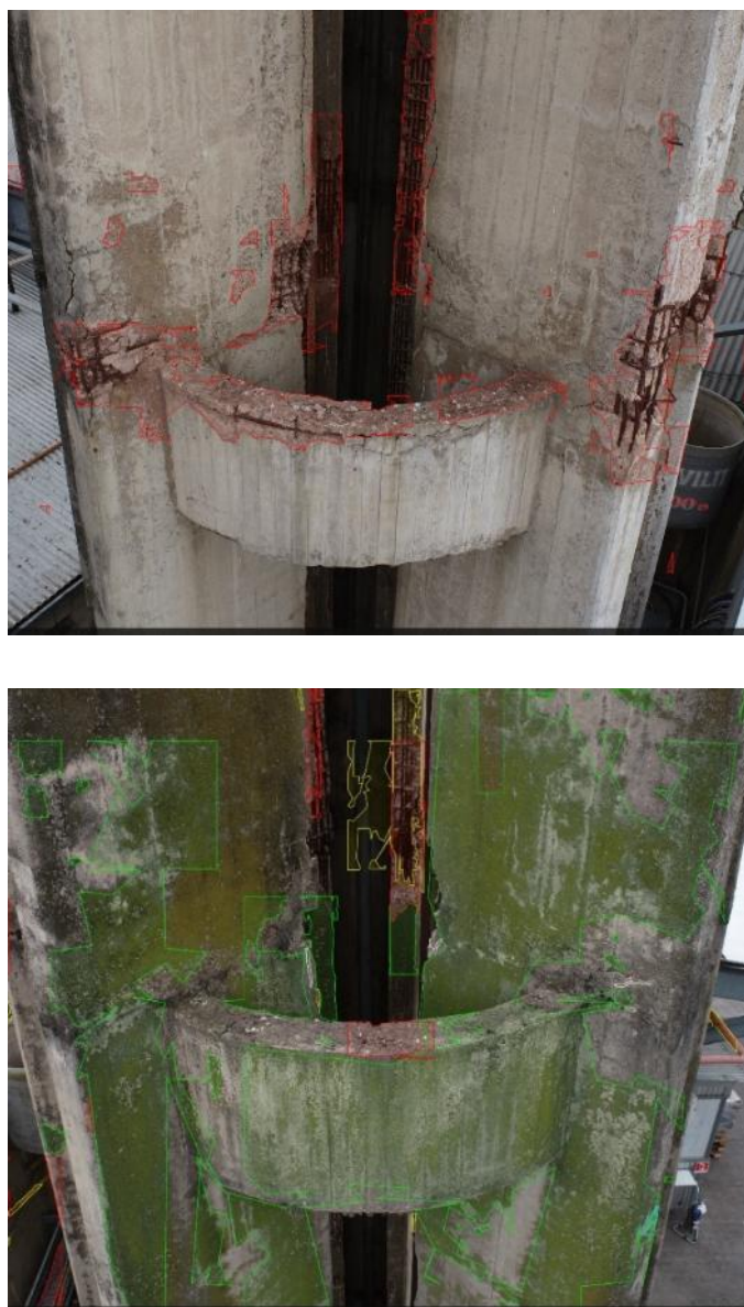
Figura 13. Detecciones representativas sobre el tanque. Imagen superior: regiones clasificadas como desprendimientos (spalling). Imagen inferior: mapa de detecciones multiclase con la totalidad de las patologías identificadas.
