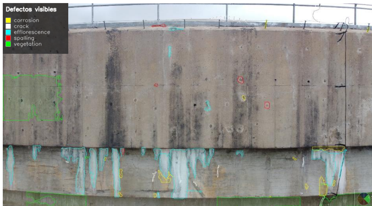
Figura 9. Vista general de un paño de la estructura de contención, con detecciones de eflorescencias en zonas de escurrimiento y manchas de corrosión. Colonización biológica leve en la base.
