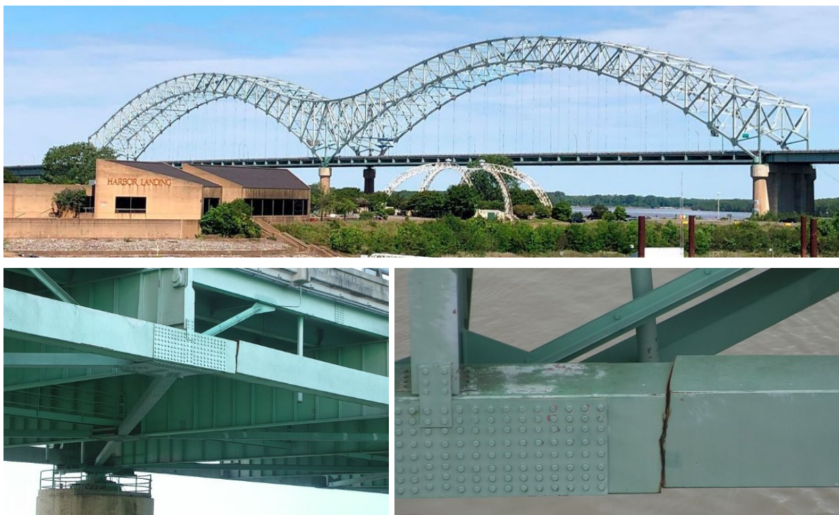
Figura 7. Fractura detectada en inspección en un tensor del puente de arco y tensor, Hernando de Soto, Memphis, EE. UU.
